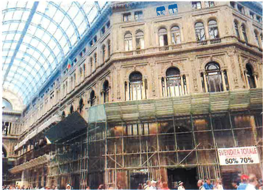
Nel mirino il civico al numero 50 della galleria Umberto per il quale il Comune ha minacciato l'esproprio se non verranno effettuati i lavori
