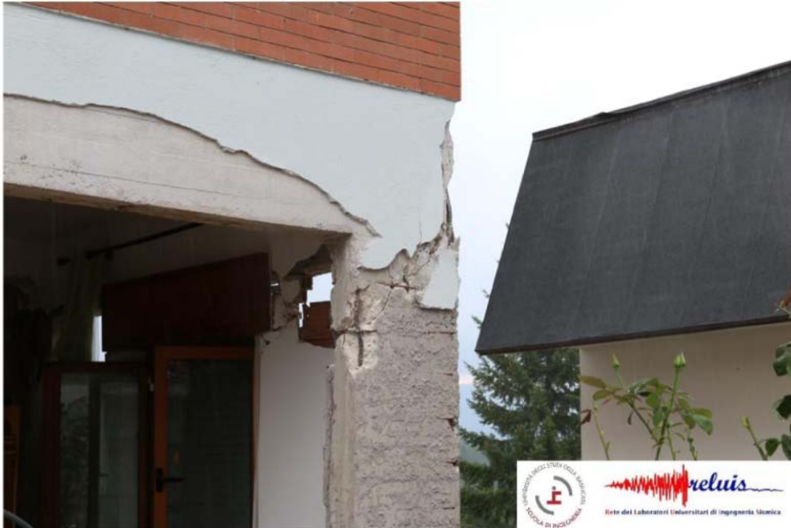
Particolare del danno ad un nodo trave-pilastro
