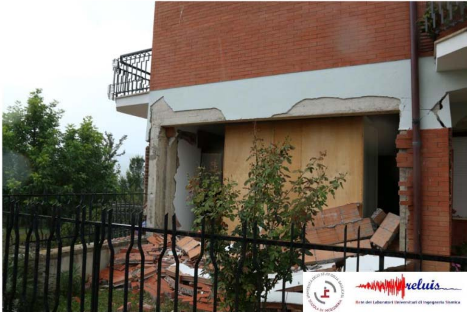
Danno alle tamponature
