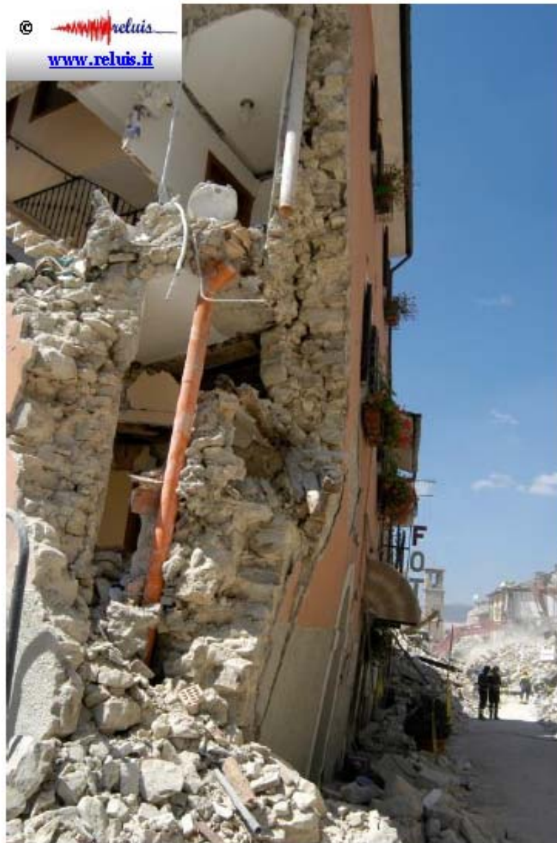
Edificio in muratura - Amatrice Evidente fuori piombo e disgregazione della parete muraria.
