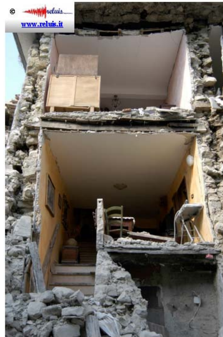
Edificio in muratura - Amatrice Parete muraria e messa in luce della sezione trasversale della muratura (doppio parallelismo delle pareti scarsamente ammassate trasversalmente).
