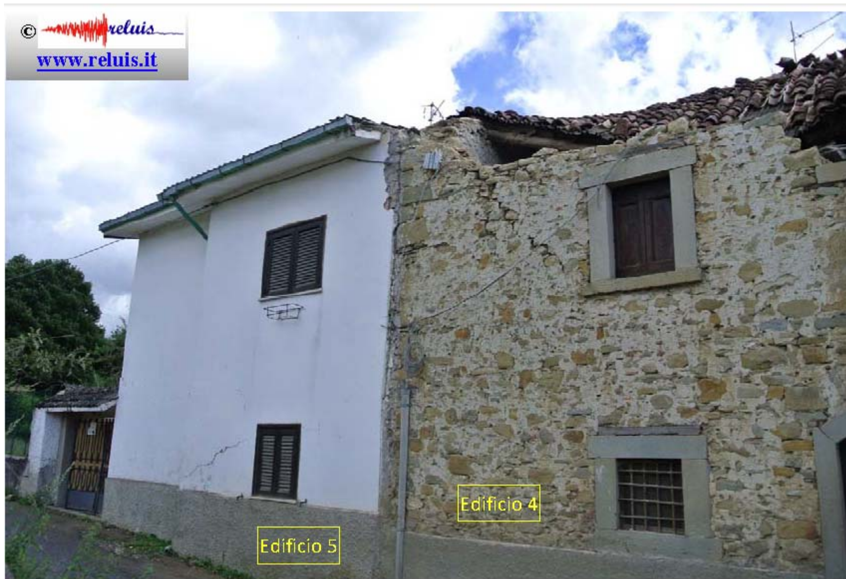
SP20-Cascello: Danneggiamento (Edificio 4); Lievi fessure diagonali (Edificio 5).
