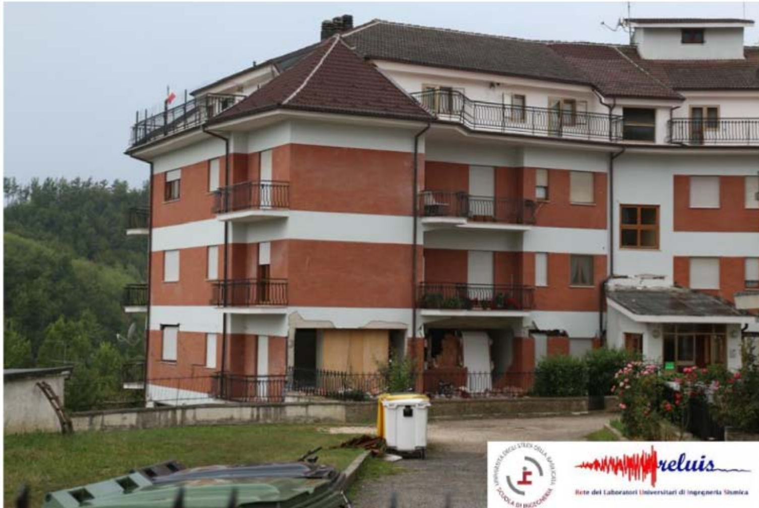
Danno alle tamponature
