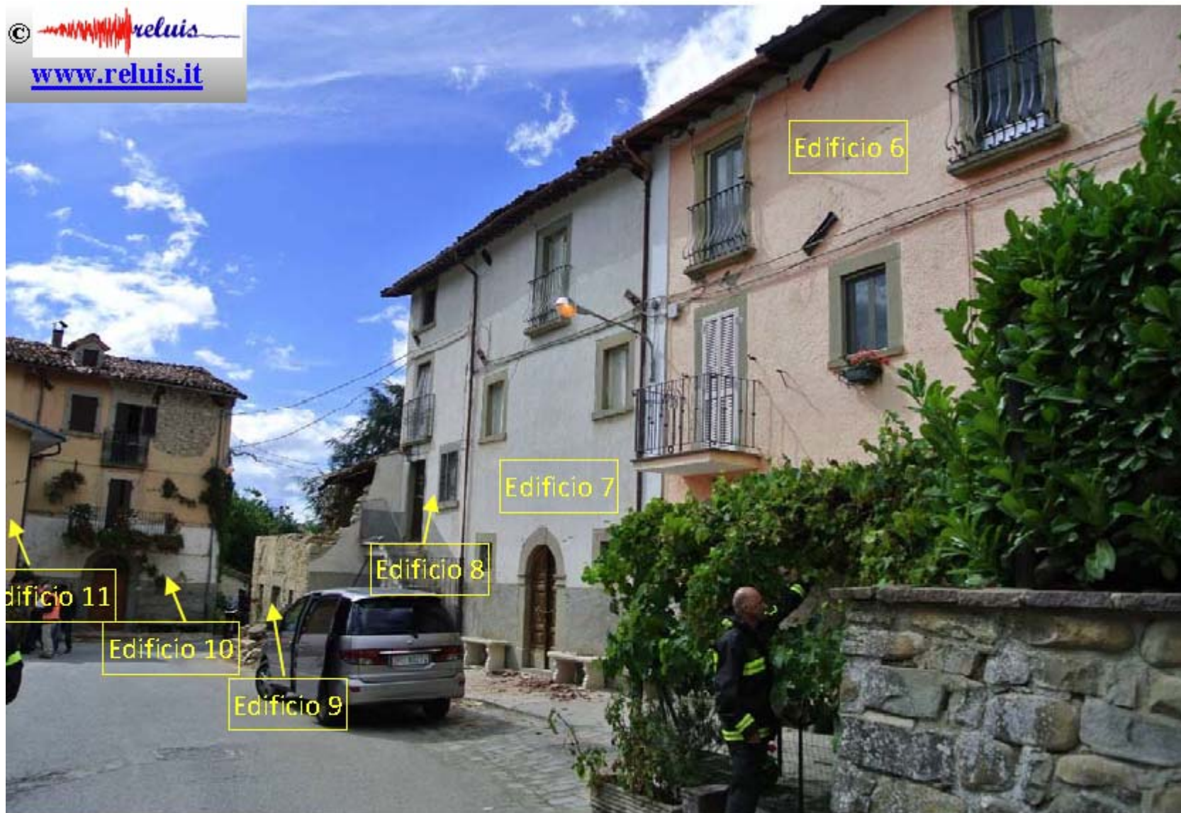
SP20-Cascello: Secondo gruppo di edifici adiacenti la SP20: presenza di catene sugli edifici 6, 7, 8, 10.
