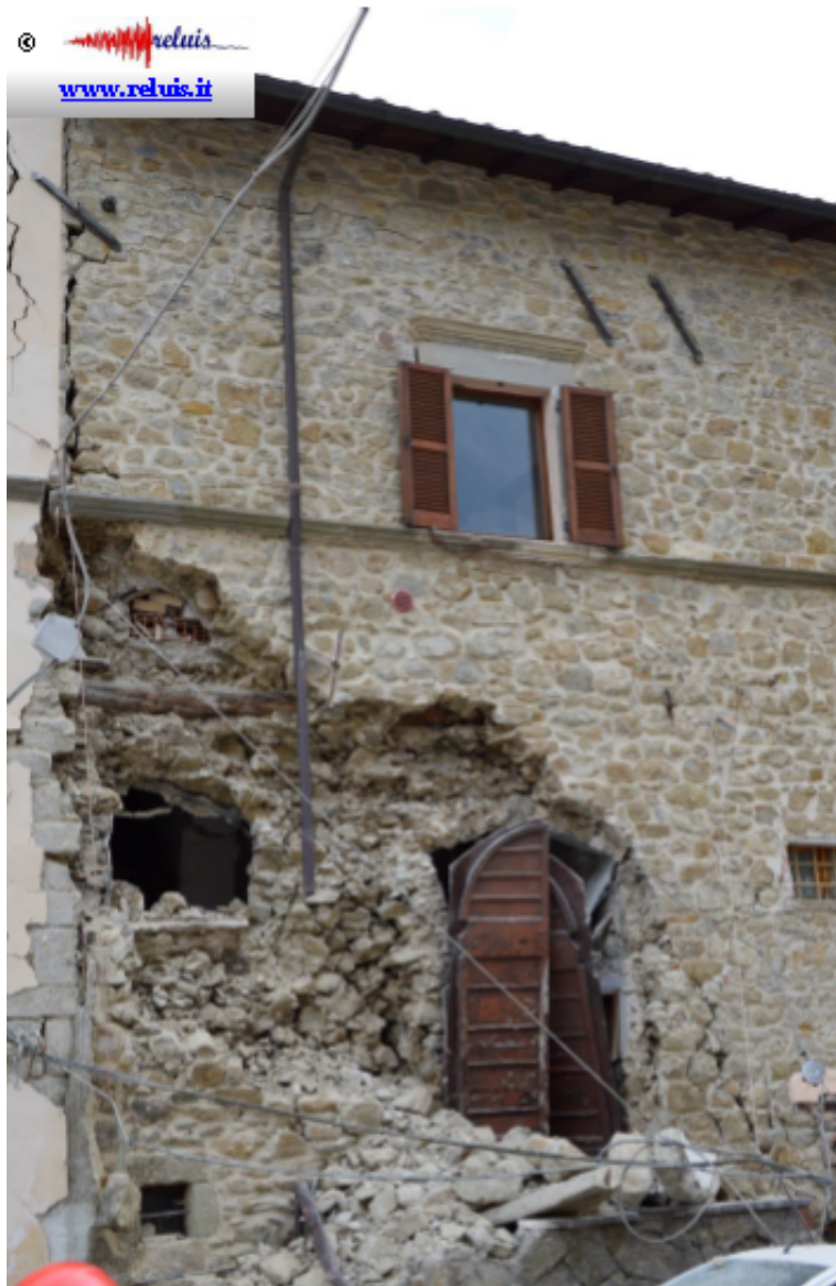
Edificio in muratura – Arquata del Tronto si disgregazione del paramento esterno della muratura. Notare la presenza delle catene, probabilmente evitato i meccanismi fuori piano
