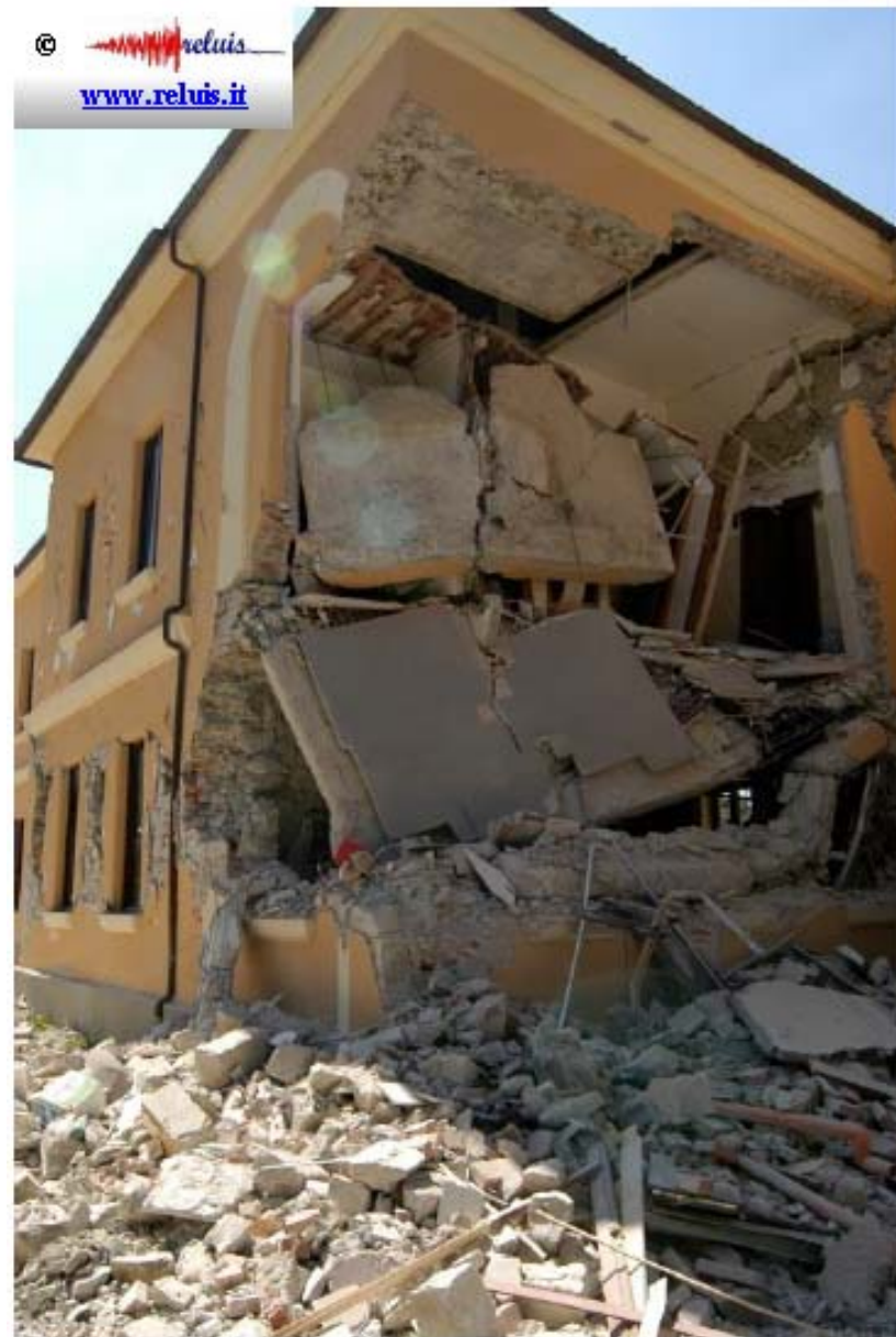
Edificio in muratura (scuola Romolo Capranica) - Amatrice Collasso delle pareti portanti e conseguente perdita di appoggio dei solai.
