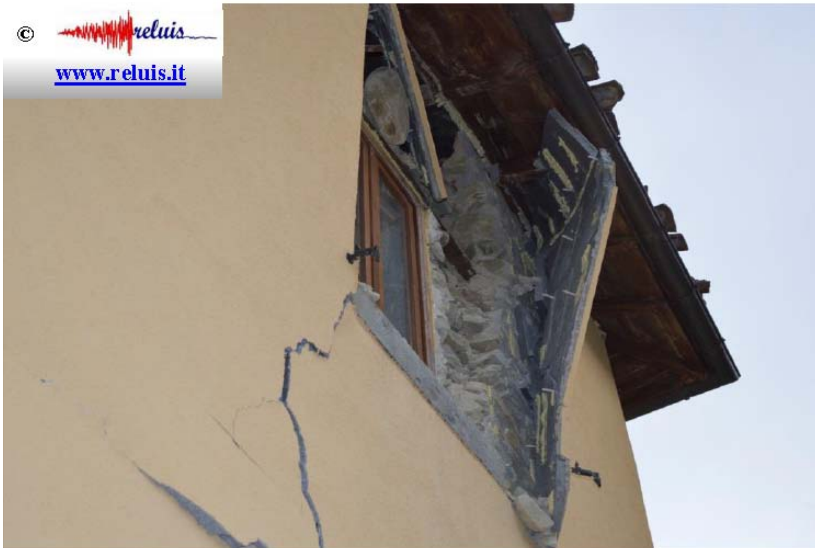
Edificio in muratura – Illica (frazione di Accumoli) Particolare del distacco di elemento non strutturale (cappotto termico).
