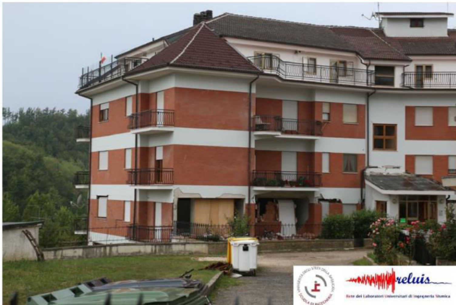
Danno alle tamponature
