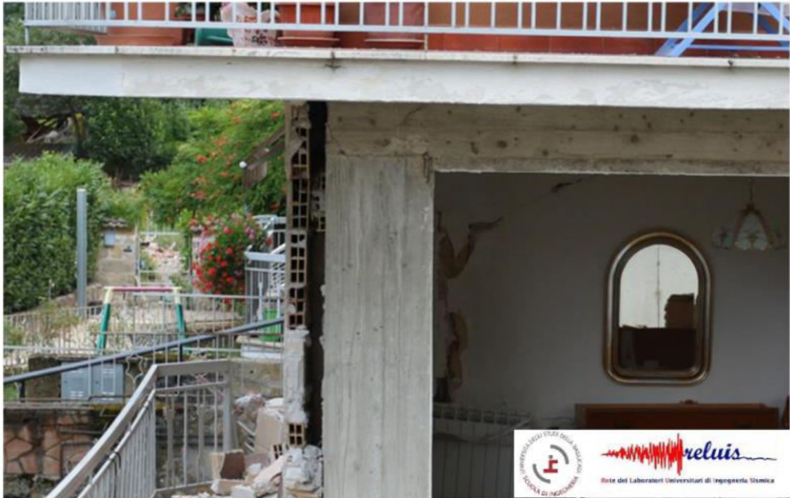
Fodera di tamponatura completamente esterna alla maglia strutturale - Danno al nodo trave-pilastro
