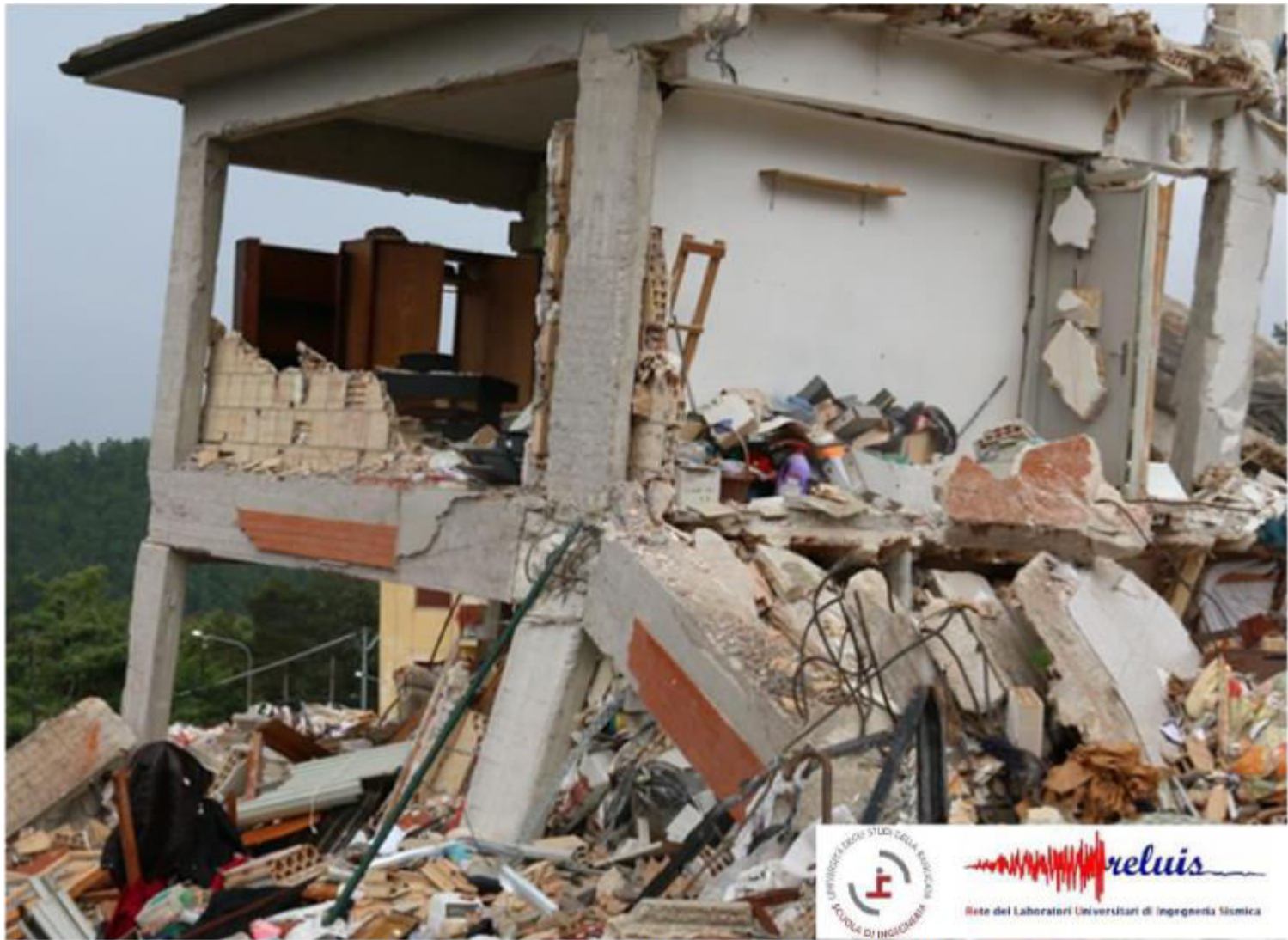
Particolare del collasso di un nodo trave-pilastro del III impalcato
