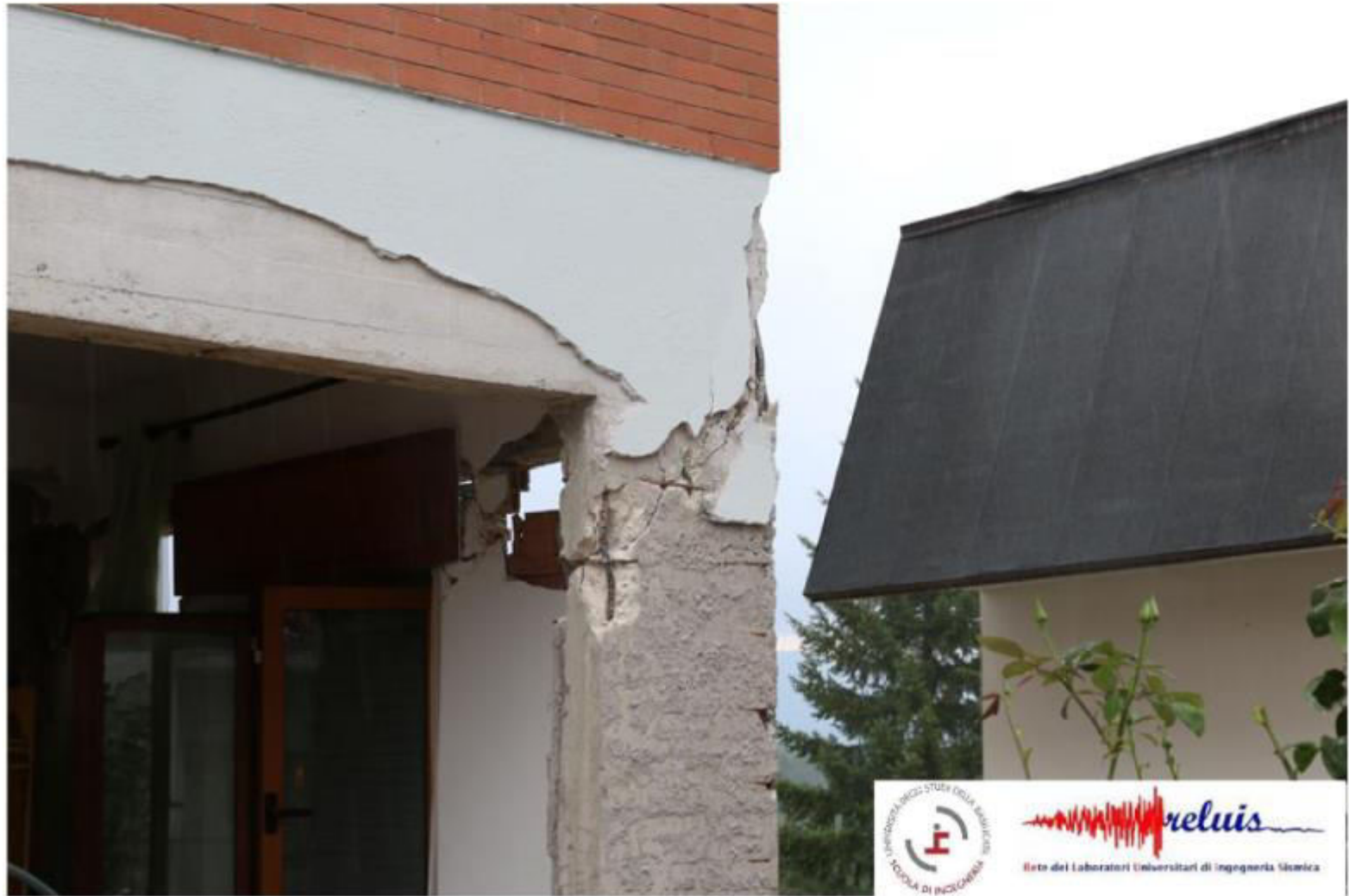
Particolare del danno ad un nodo trave-pilastro
